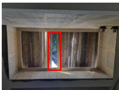
图 4 孔洞缺口（仰视）
